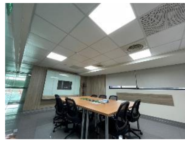
全廠更換省電LED照明
